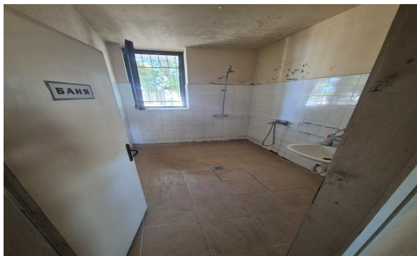
Обща баня със следи от влага по стените и рушаща се мазилка
